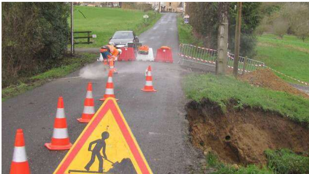
La route de Bousse (Sarthe) est coupée après un effondrement de terrain dimanche 15 février 2026. |
